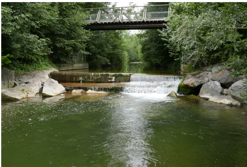
Bild 8 Schwelle bachabwärts Brücke Säntisstrasse. Blick gegen Fliessrichtung.
