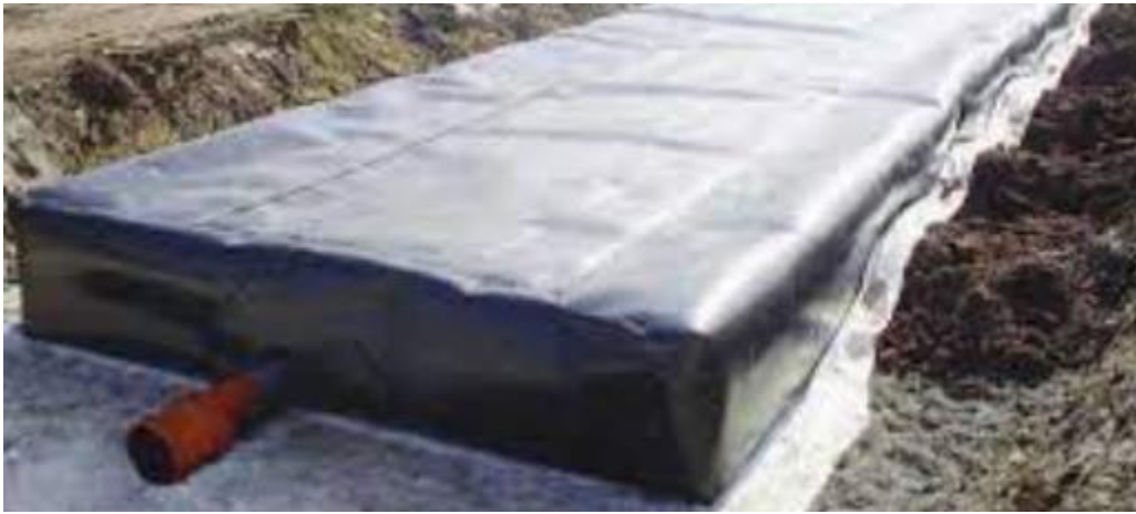
Abbildung 4: Rausikko Boxen – Unterirdische Retentionsanlagen
